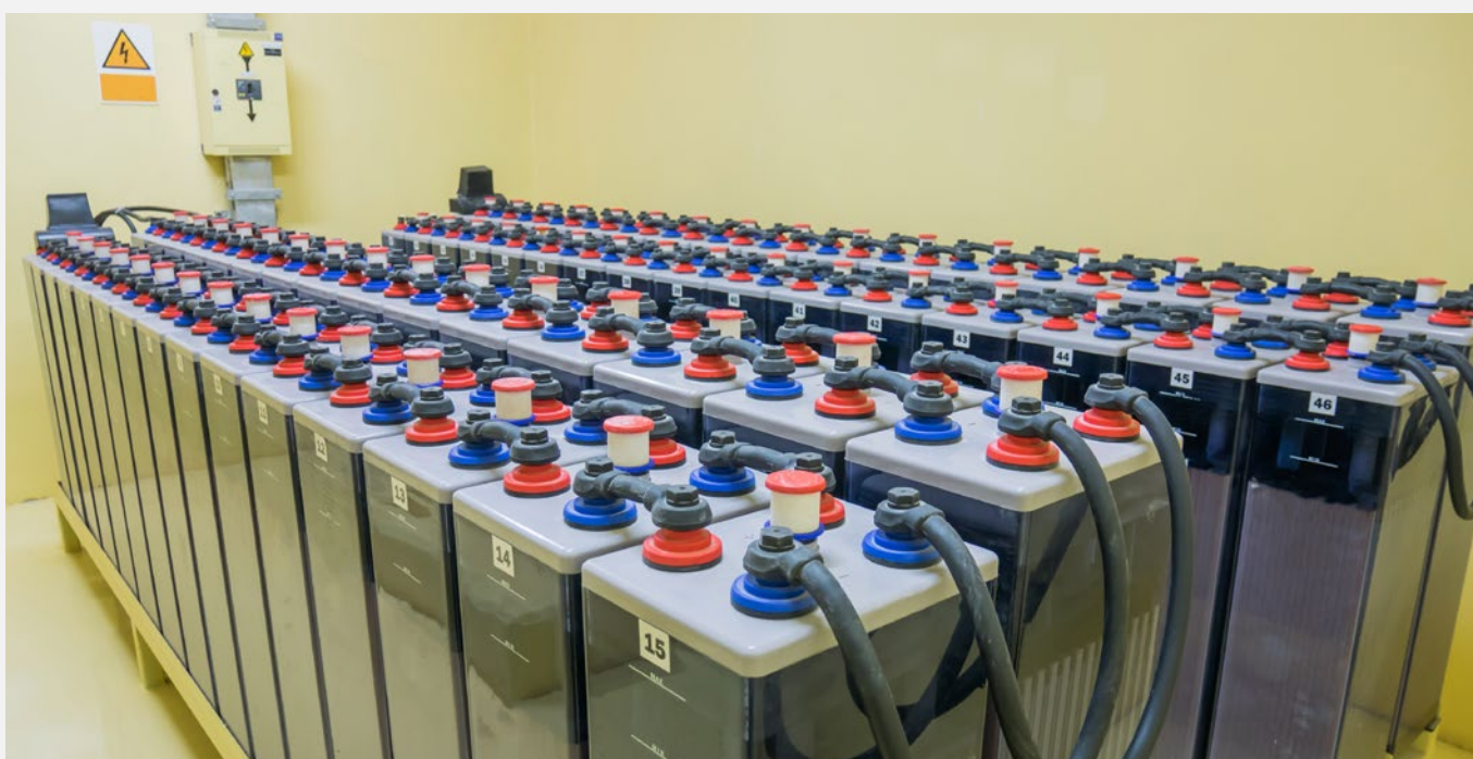
Obr. 1: Příklad stacionárního bateriového úložiště (staniční baterie)
